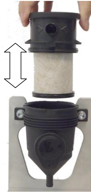
Fig. 13 Remplacement du séparateur d'huile du ProVent 150
